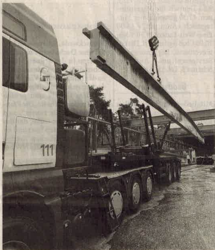
Zentimeter-Arbeit: An zwei Kränen hängend wurden die Binder auf die bereit stehenden Lkws verladen.
