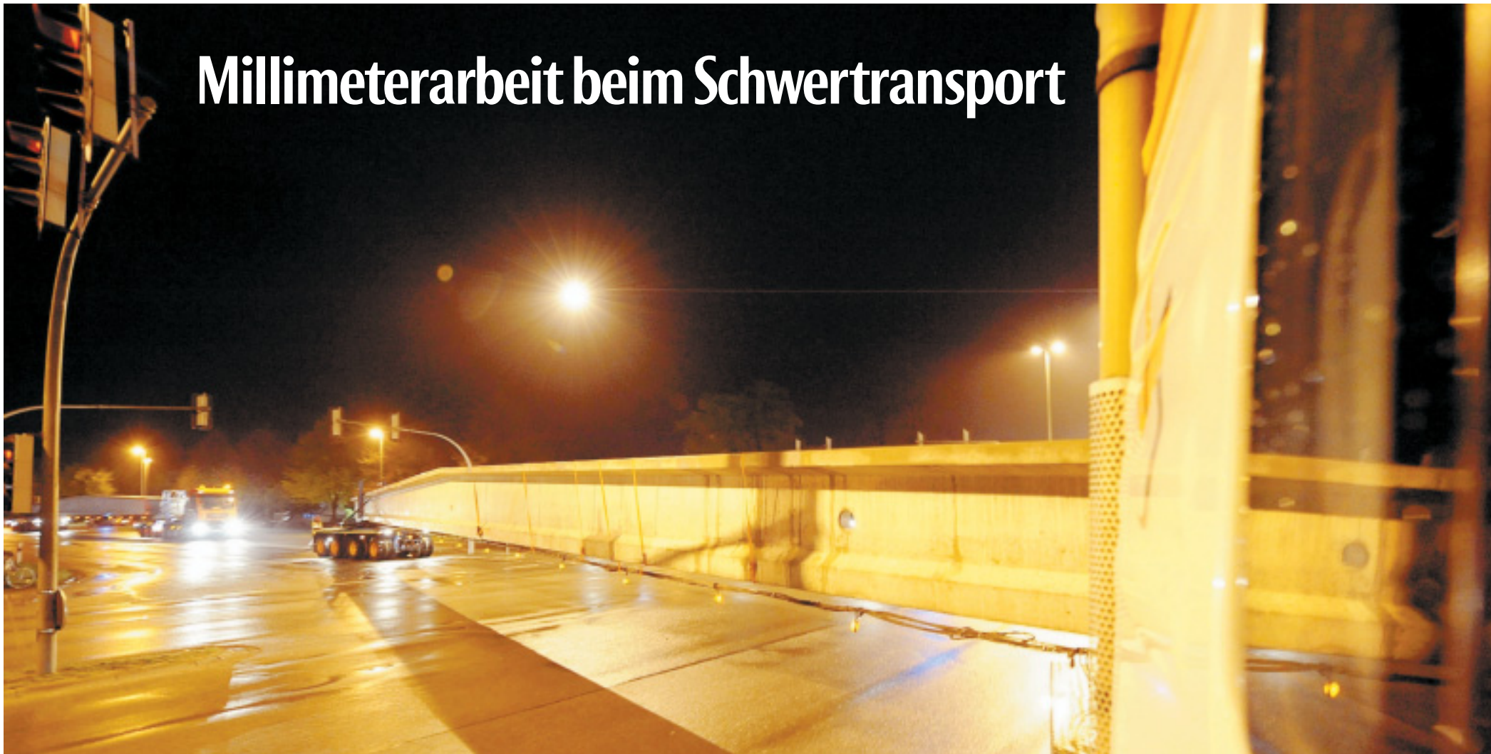
Blick zurück: Der 41 Meter lange Betonbinder spiegelt sich im Fenster des Sattelschleppers, während der Koloss von der Lämershagener Straße auf die B 68 einbiegt. Der zweite Transporter folgt.
